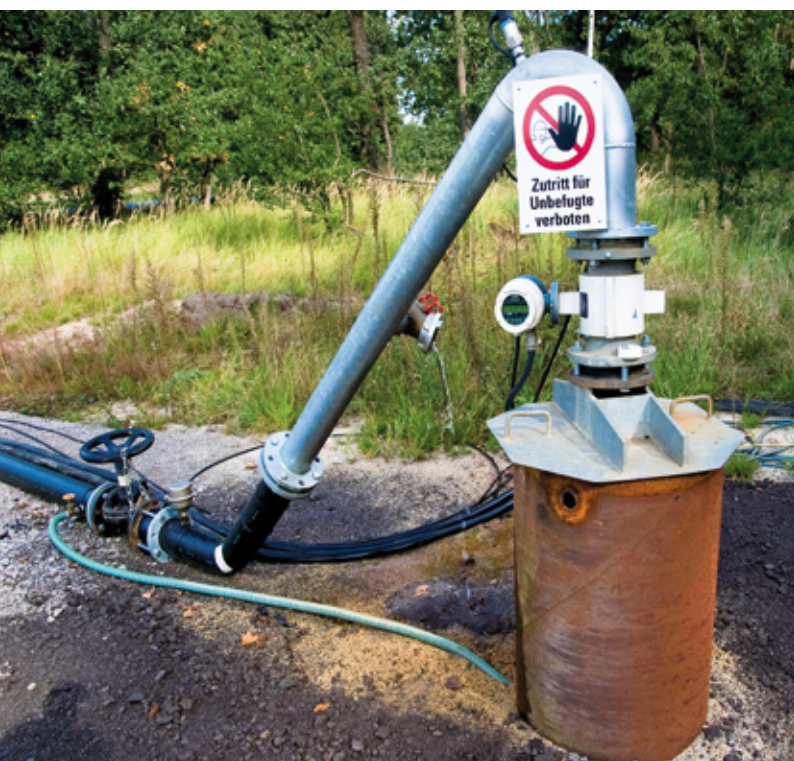
Grundwasserbrunnen an einem Vattenfall-Tagebau
