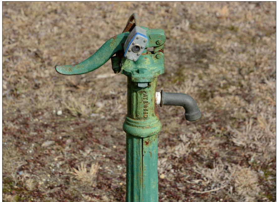
Abgeschlossener Wasserhahn in ausgetrockneter Umgebung
